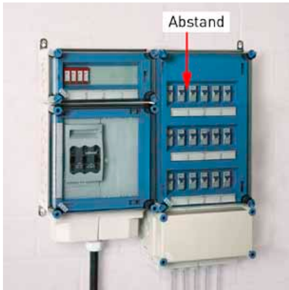
Bild 14: Verteiler für PV-Anlage (Quelle Hensel)
