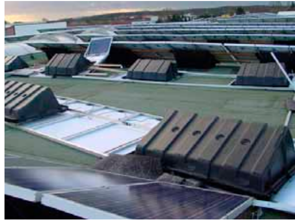
Bild 8: Sturmschaden durch Nichtbeachtung der Systemstatik (Quelle Mannheimer)
