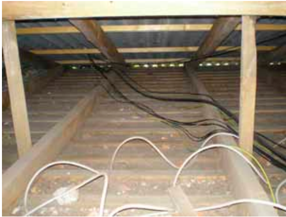
Bild 12: Nicht fachgerechte Leitungsverlegung (Quelle VGH)
