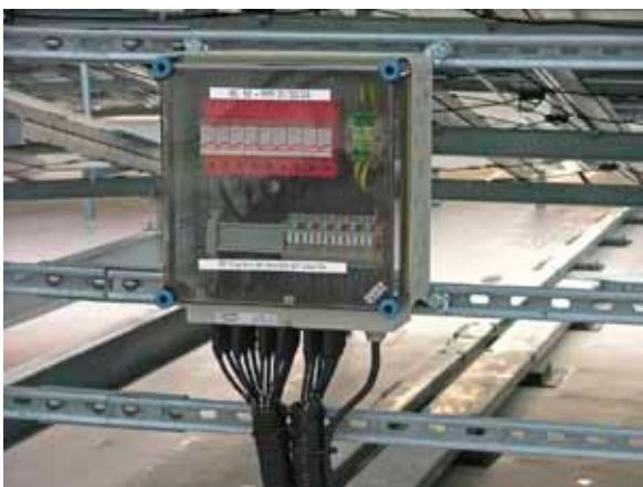
Bild 19: Generatoranschlusskasten mit Überspannungsschutzgeräten (Quelle Hensel)
