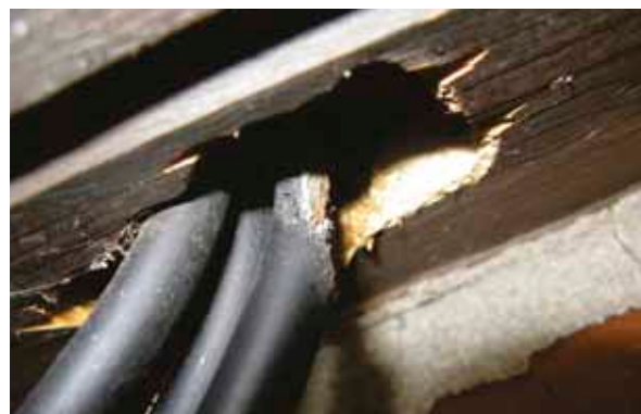
Bild 10 und 11: Beschädigungen von Leitungen (Quelle Markus Scholand)
