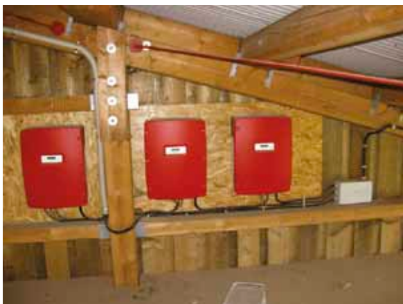
Bild 9: Montage von Wechselrichtern auf brennbaren Untergründen ist nur mit Zustimmung des Herstellers erlaubt. (Quelle Markus Scholand)
