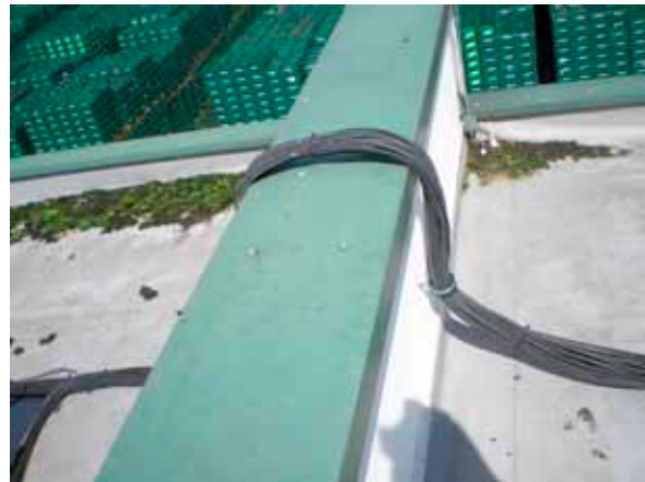
Bild 3: Nicht erlaubte Verlegung von Leitungen über eine Brandwand (Quelle VGH)
