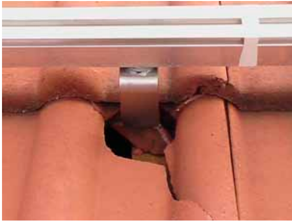
Bild 7: Fehlerhafte Planung (Quelle Mannheimer)
