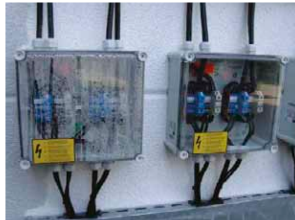
Bild 15: Kondenswasserbildung im Generatoranschlusskasten (Quelle Markus Scholand)
